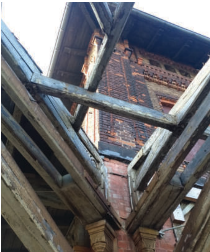
Der hölzernen, teils ungeschützt Wind und Wetter ausgesetzten Unterkonstruktion der Perronüberdachung droht Totalverlust. Foto: Thomas Krueger.
