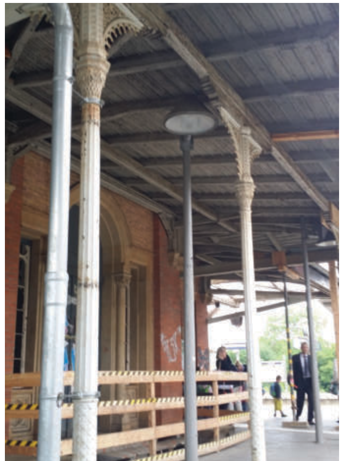
Ohne jedes Gespür für die qualitätsvolle historische Bausubstanz wurden „moderne“ Bauelemente für den Bahnbetrieb installiert, wie z.B. Regenrohre an die original erhaltenen gusseisernen Perrondachsäulen oder Beleuchtungskörper „von der Stange“. Foto: Thomas Krueger
